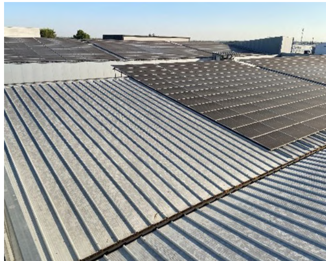
Placas solares instaladas en nuestra bodega
